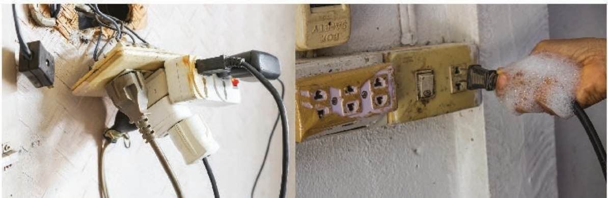
Figura 5.9 Acciones de riesgo al usar la electricidad: a) Saturar las conexiones de un multicontacto o de un contacto de pared o tener la instalación eléctrica en malas condiciones; b) Tocar los cables con las manos mojadas o no usar el equipo de protección adecuado.
